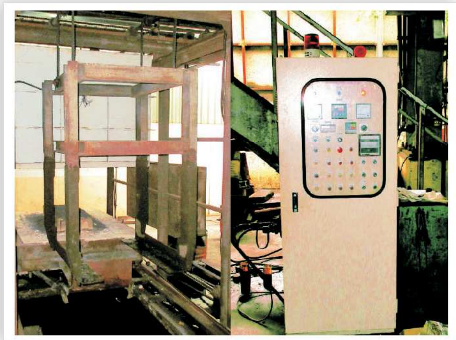
▼ 熱處理設備 FURNACE FOR HEAT TREATMENT
